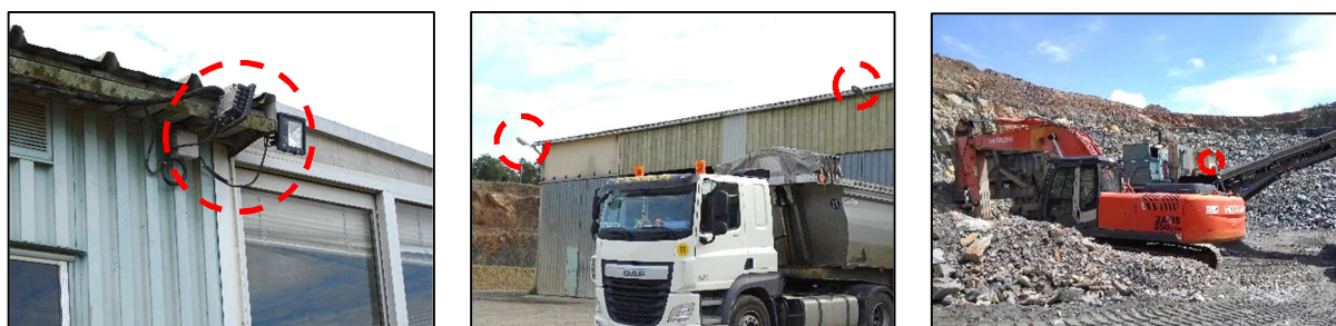
Figure 61 - Exemple de dispositifs d'éclairage en place au niveau des locaux sociaux, de l'atelier et du concasseur primaire
